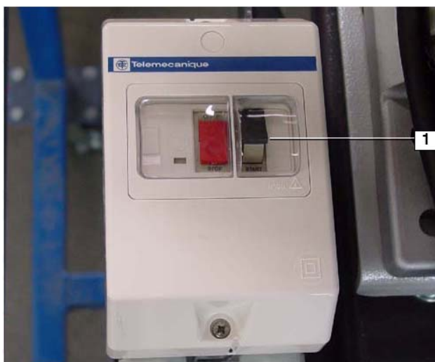
Рис.12. Контактная коробка с автоматом защиты электродвигателя
